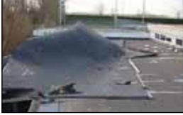
SCHADE PLAT DAK
