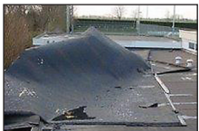
SCHADE PLAT DAK
