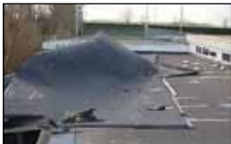
SCHADE PLAT DAK
